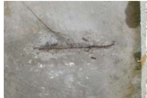
■コンクリート表面の剥離
